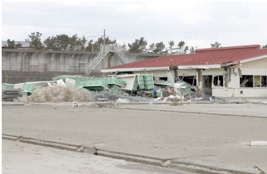
写真6. 破壊された種市港の建物と背後の防潮堤 (2011/4/3)
