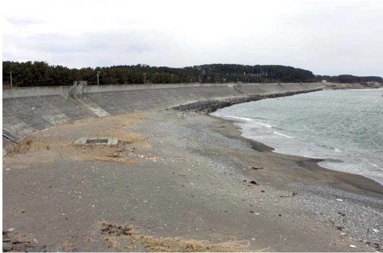
写真7. 川尻川河口付近の防潮堤 (2011/4/3)
